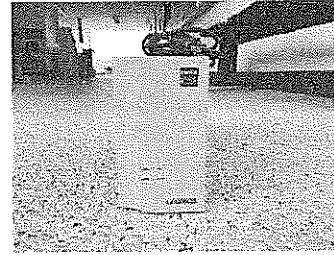
42. เครื่องสำรองไฟ
